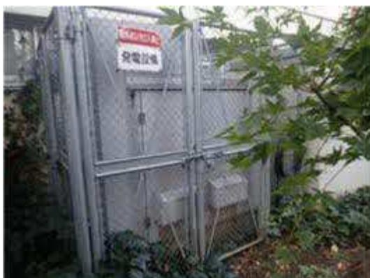
非常用発電設備（軽油で動作）
