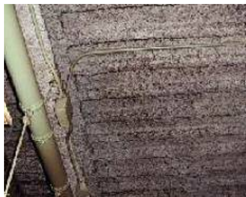
石綿含有吹付けロックウール
