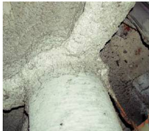
吹付けアスベスト
