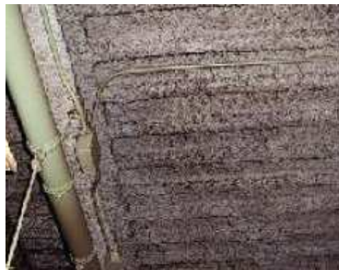
石綿含有吹付けロックウール
