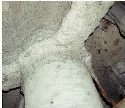
吹付けアスベスト
