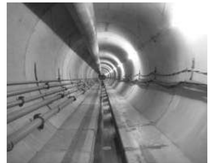
雨水排水管(シールドトンネル)
