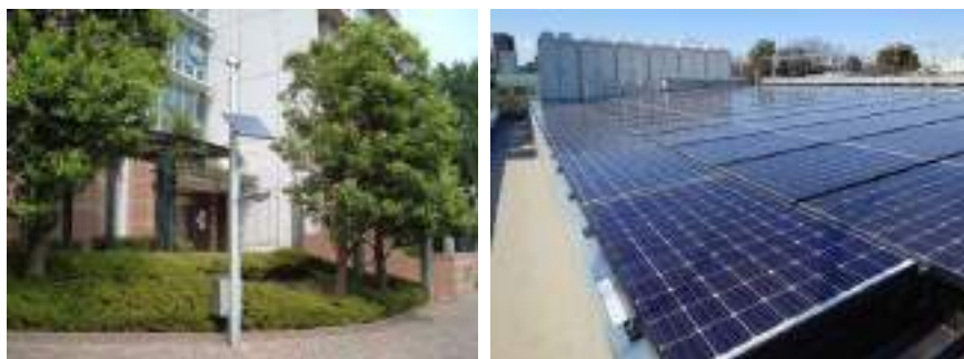
区有建築物における太陽光発電設備の設置状況
