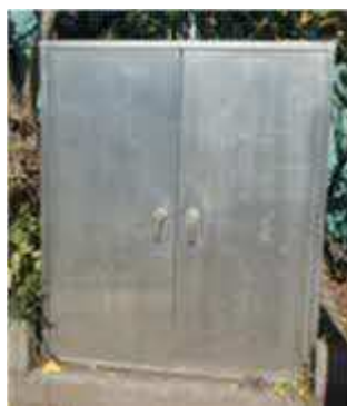
自動式ろ過機 倉庫外観
