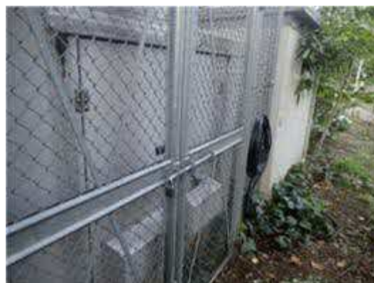
非常用発電設備（手前）
