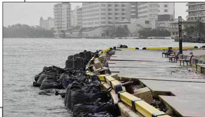
崩落した護岸 (R6.1.1能登地震) 出典：産経新聞WEB
