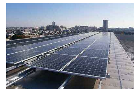
太陽光パネルの例 (出典：葛飾区HP)
