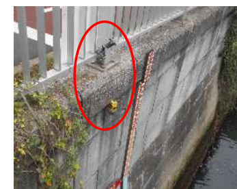
市場橋に設置した臭気計 および水面定点カメラ
