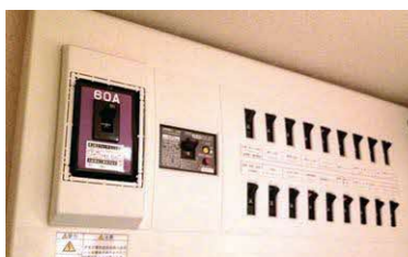
ブレーカーの一例
