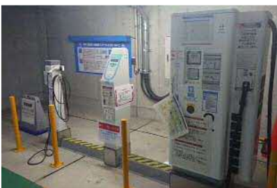
電気自動車充電スタンド(EVステーション)
