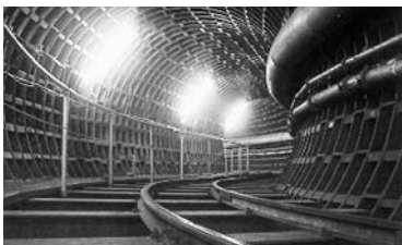
工事中の雨水バイパス管（内径3.25m）平成17年完成（西五反田1丁目付近）
