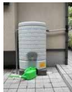
雨水利用タンク
