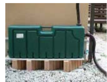
雨水利用タンク
