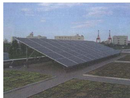
太陽光パネル（品川区資源化センター）
