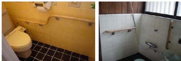
手すりの設置等のバリアフリー工事事例(東京都住宅バリアフリー推進協議会)
