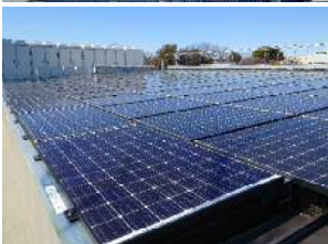
区有建築物に設置 されたソーラーパネル
