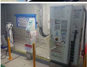
電気自動車充電 スタンド (EVステーション)
