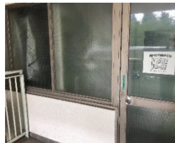
外からしかアクセスできない室（漏水発生）
