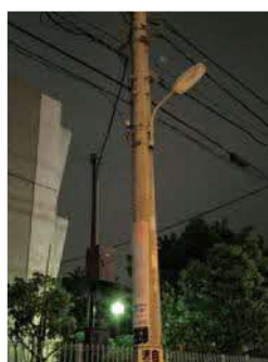
街路灯の不点灯
