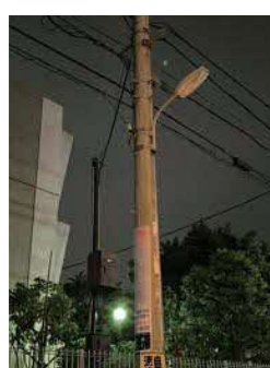
街路灯の不点灯
