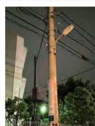
街路灯の不点灯
