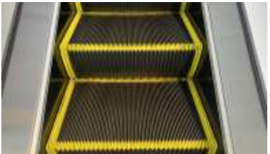
明度差を確保した事例
