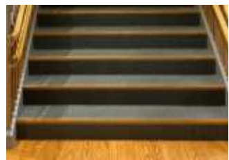
明度差を確保した事例
