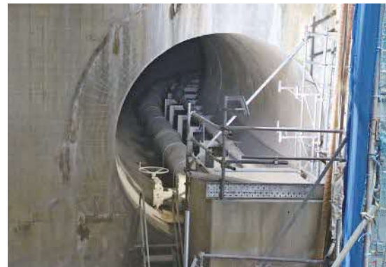
東京都の「暫定貯留施設」(立会川)
