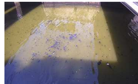
スカムの発生状況 (令和6年7月 市場橋付近)
