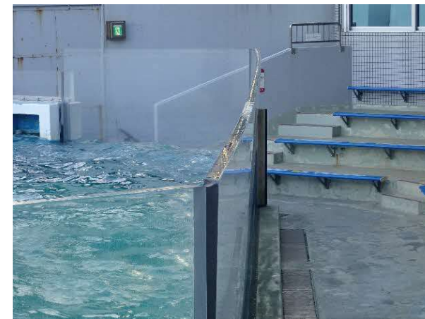
写真2 イルカプールのアクリル板たわみ
