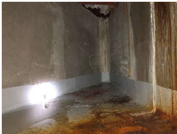
写真1 水槽下の漏水と躯体劣化
