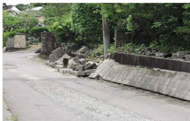
平成 28(2016)年 熊本地震における嘉島町の ブロック塀の被害
