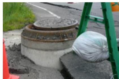
液状化によるマンホールの浮き上がり
