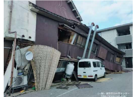
令和6(2024)年 能登半島地震の 建物被害
