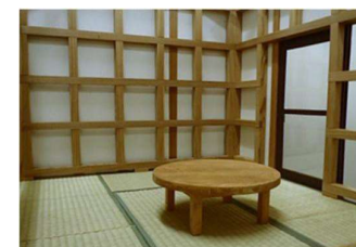
シェルター模型の内部
