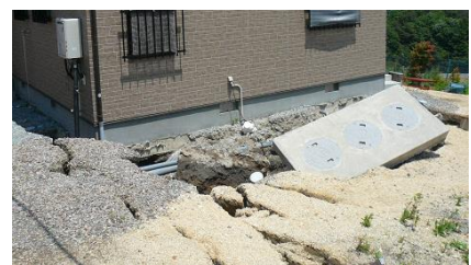
液状化による被害
