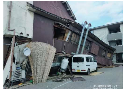
令和6(2024)年 能登半島地震の 建物被害
