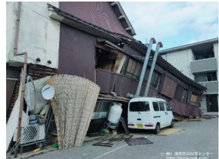
令和6(2024)年 能登半島地震の 建物被害
