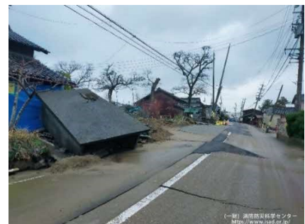
令和6(2024)年 能登半島地震の 建物被害
