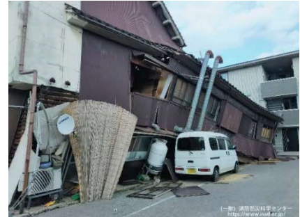
令和6(2024)年 能登半島地震の 建物被害
