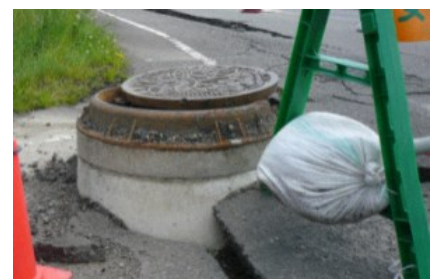
液状化によるマンホールの浮き上がり
