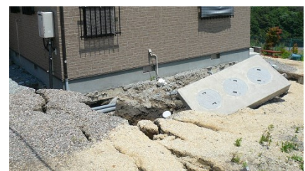
液状化による被害
