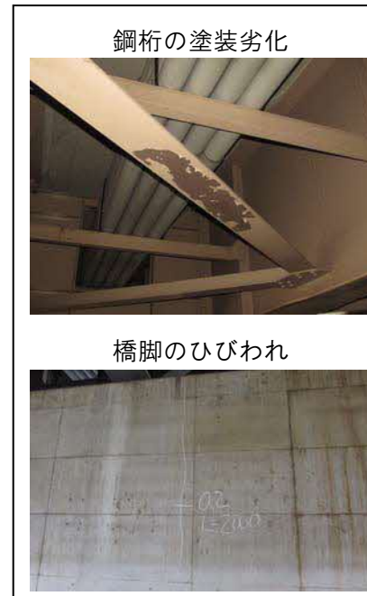
写真 1. 勝島橋の劣化・損傷状況
