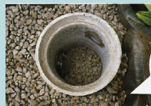
雨水浸透ます
