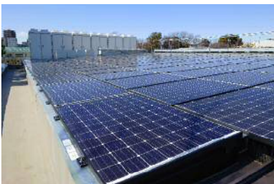
区有建築物に設置されたソーラーパネル
